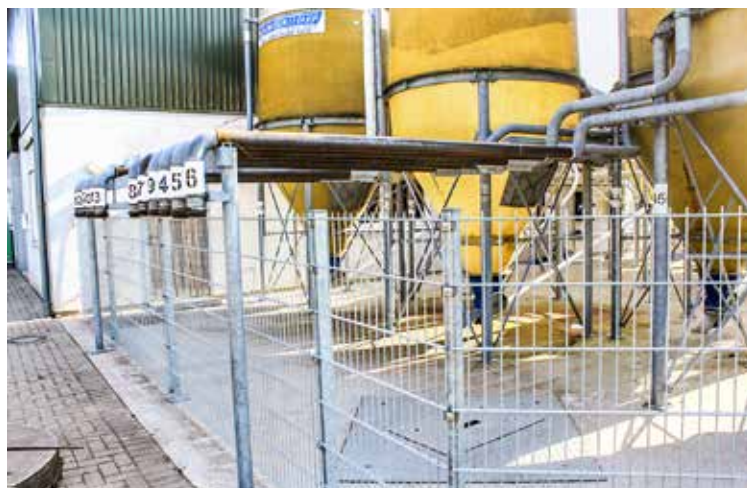
Die Verlängerung der Anschlüsse ermöglicht ein Befüllen der Futtersilos, ohne den eingefriedeten Bereich zu betreten. Foto: Dr. Onno Burfeind
