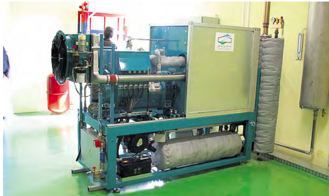
Ein Blockheizkraftwerk von 80 kWel.
